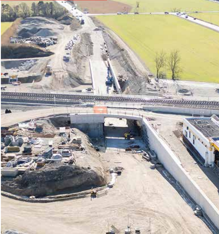
Die Arbeiten an der Unterführung der B54 schreiten voran und sind weiterhin voll im Zeitplan. Die Fertigstellung ist für Anfang Juni geplant.
